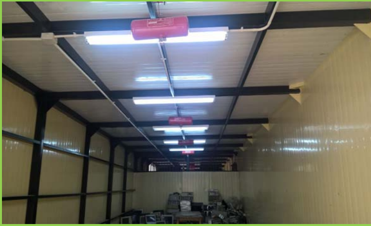
طفايات الحريق (بودة ذاتية التشغيل) بالمخزن الأول خلف قسم الكيمياء
