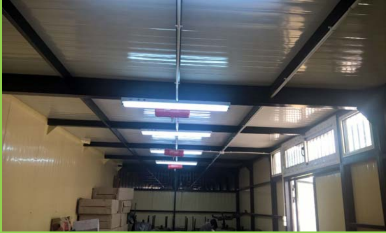
طفايات الحريق (بودة ذاتية التشغيل) بالمخزن الثاني خلف قسم الكيمياء
