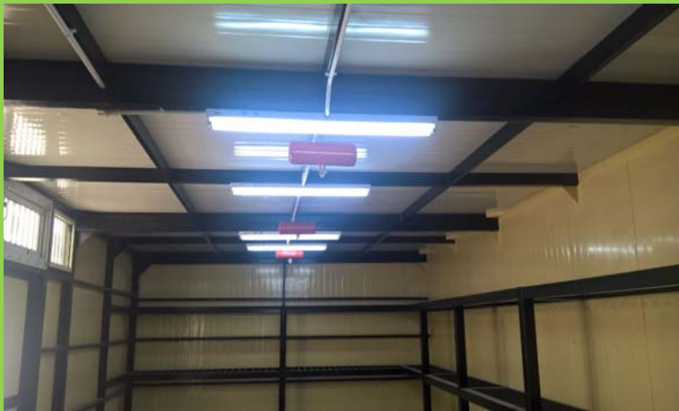
طفايات الحريق (بودة ذاتية التشغيل) بالمخزن الثالث خلف قسم الكيمياء
